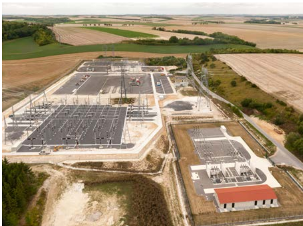
Extension du poste 400 kV de Seuil
