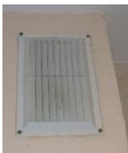
Grille d'extraction d'air
