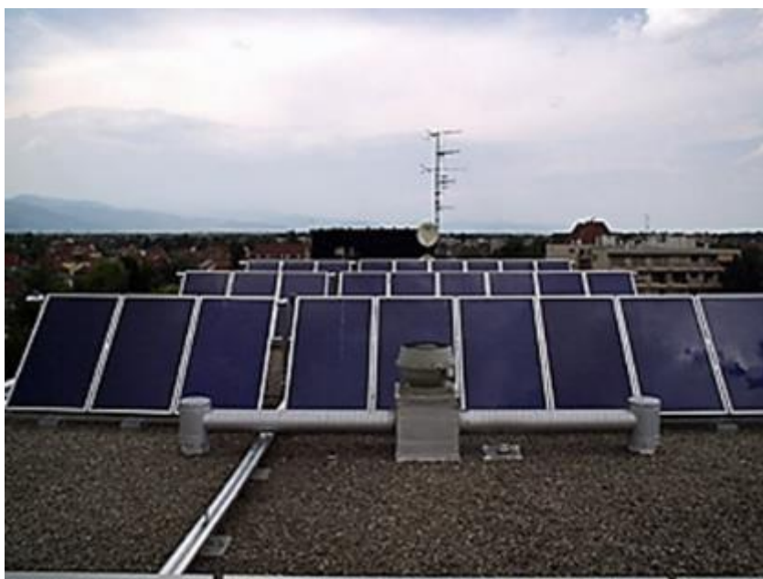
Capteurs solaires thermiques
