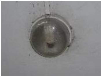
Eclairage de hall
