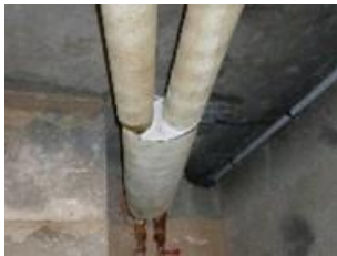
Réseau de chauffage calorifugé en sous sol
