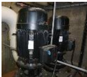
Circulateurs de chauffage en sous station (bâtiment 7)
