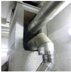
Réseau de chauffage calorifugé en chaufferie
