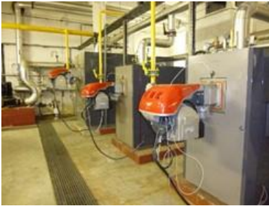
Chaudières gaz à condensation
