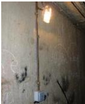
Eclairage incandescence sur minuterie en sous sol
