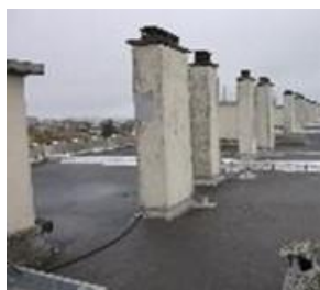
Conduits shunt en toiture
